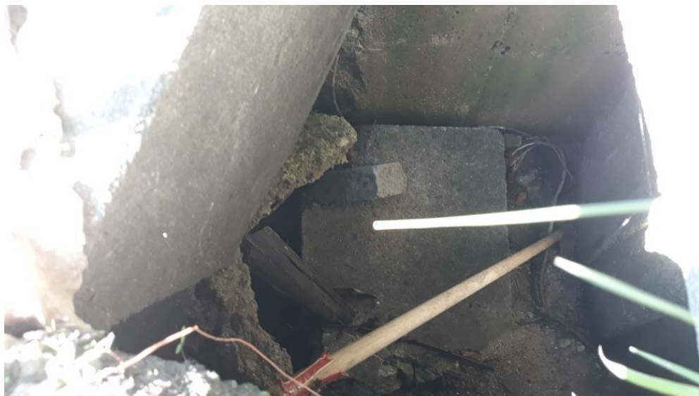
Figura 13 – Caixa de passagem pluvial seca na Rua Padre Lourenço Rodrigues de Andrade. Local: Coordenadas Sirgas 2000 UTM 745286/6955131.
