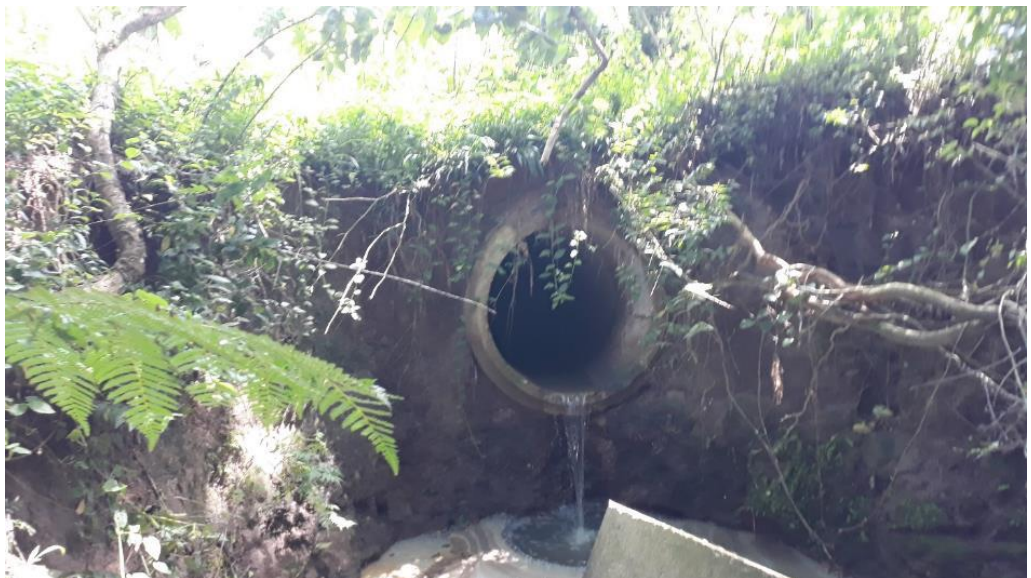
Figura 9 - Tubulação de águas pluviais e servidas que vem da rodovia e que foi redirecionada pelo PODER PÚBLICO ao terreno Estudado sem nenhum tipo de autorização. Neste local é que o levantamento da ANA identifica como “curso d'água”.
