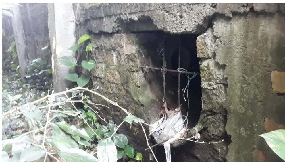
Figura 14 – Tubulação de águas pluviais e esgoto provenientes da Rua Padre Lourenço Rodrigues de Andrade. Local: Coordenadas Sirgas 2000 UTM 745351/6955104.
