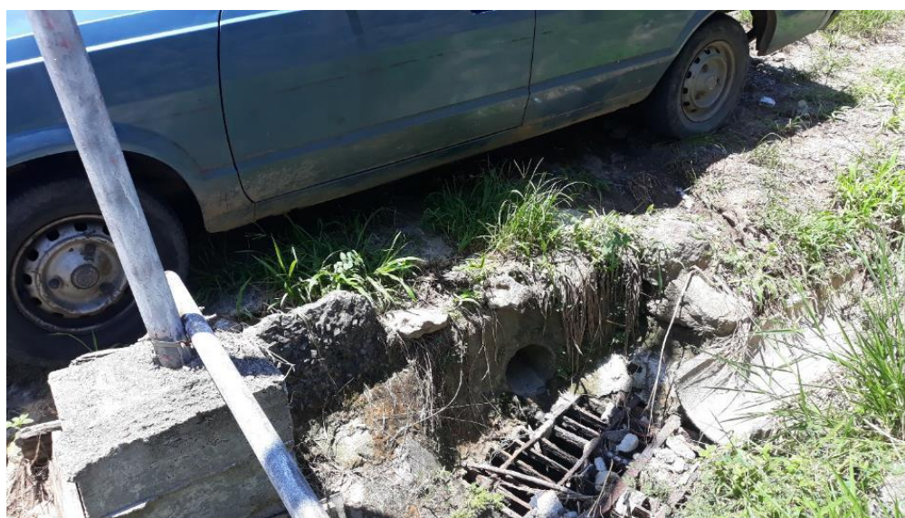
Figura 18 – Caixa de passagem pluvial proveniente da SC-401. Local: Coordenadas Sirgas 2000 UTM 745551/6955189.
