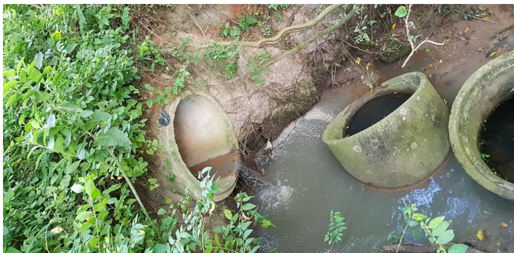
Figura 3 – Local apontado como sendo o curso d'água, em verdade um sistema de esgoto cloacal tubulado e com origem nas casas e comércios do entorno. (Coordenadas 27°30'20.27"S/ 48°30'56.07"O)
