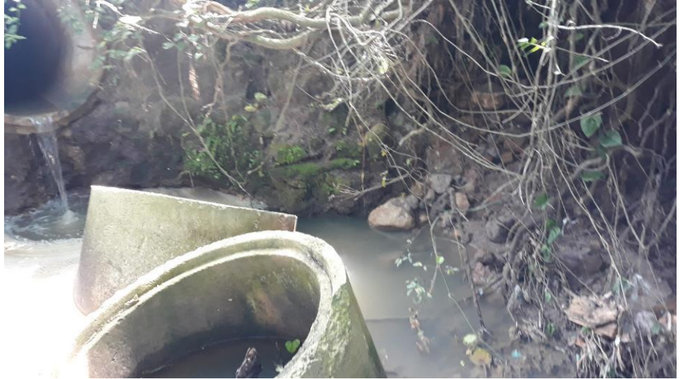
Figura 10 – Nítido lançamento de efluentes domésticos não tratados. Local: Coordenadas Sirgas 2000 UTM 745431/6955104.
