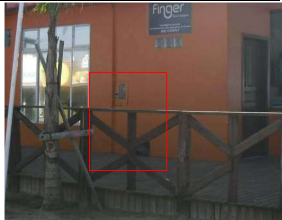
Foto 14 – Medidor de energia elétrica e água existente nas edificações.
